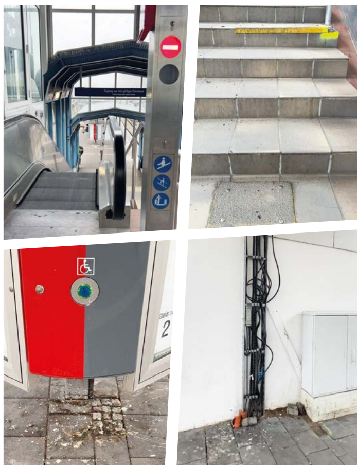
Verdreht, kaputte Treppen, offene Kabelschächte: Der Blankeneser Bahnhof wirkt vernachlässigt. Fotos: mk
